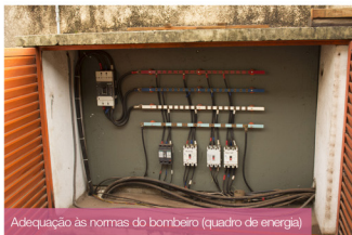
Adequação às normas do bombeiro (quadro de energia)
